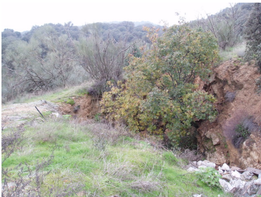
2. Borde del socavón San Eusebio, una vez tapado.
