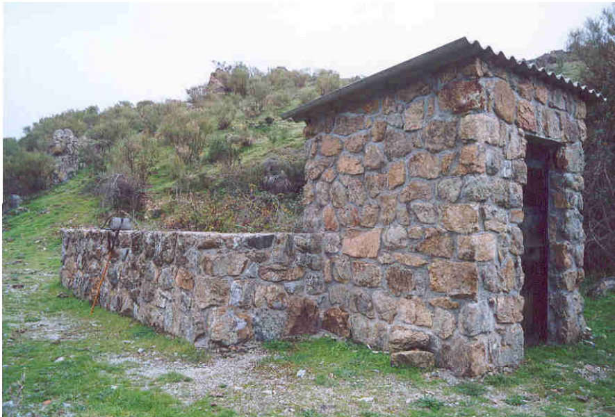
2. Pozo maestro y caseta de bombas, para abrevadero y otros usos.
