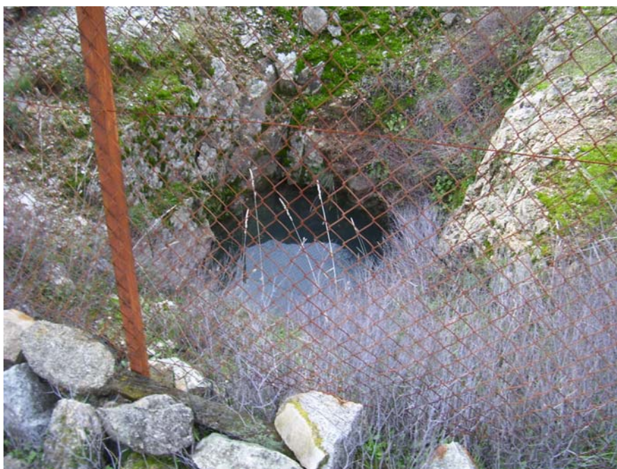
1. Pozo inundado, con vallado de protección.
