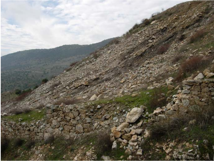
1. Escombreras y muros de mampostería a lo largo del carril de carga.
