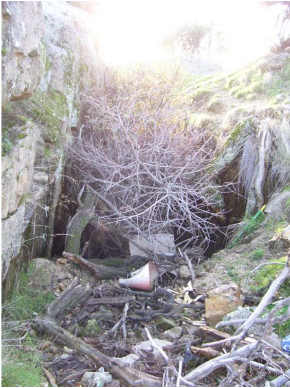
2. Bocamina cubierta de basura.
